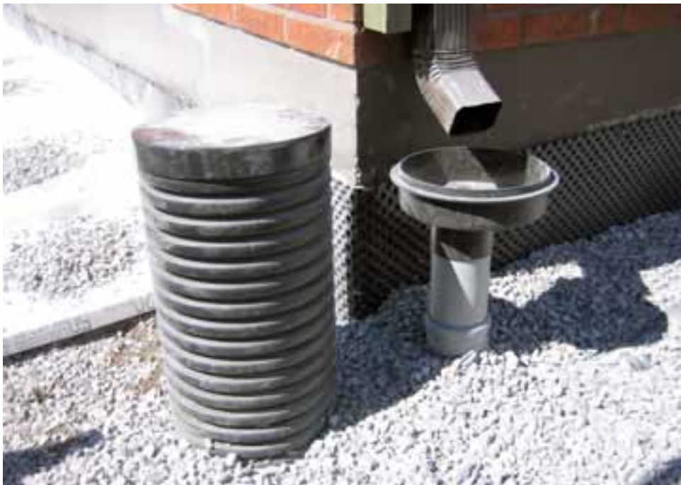
Kuva 18-2 Rännikaivo ja salaojakaivo. (Tapio Helenius)
