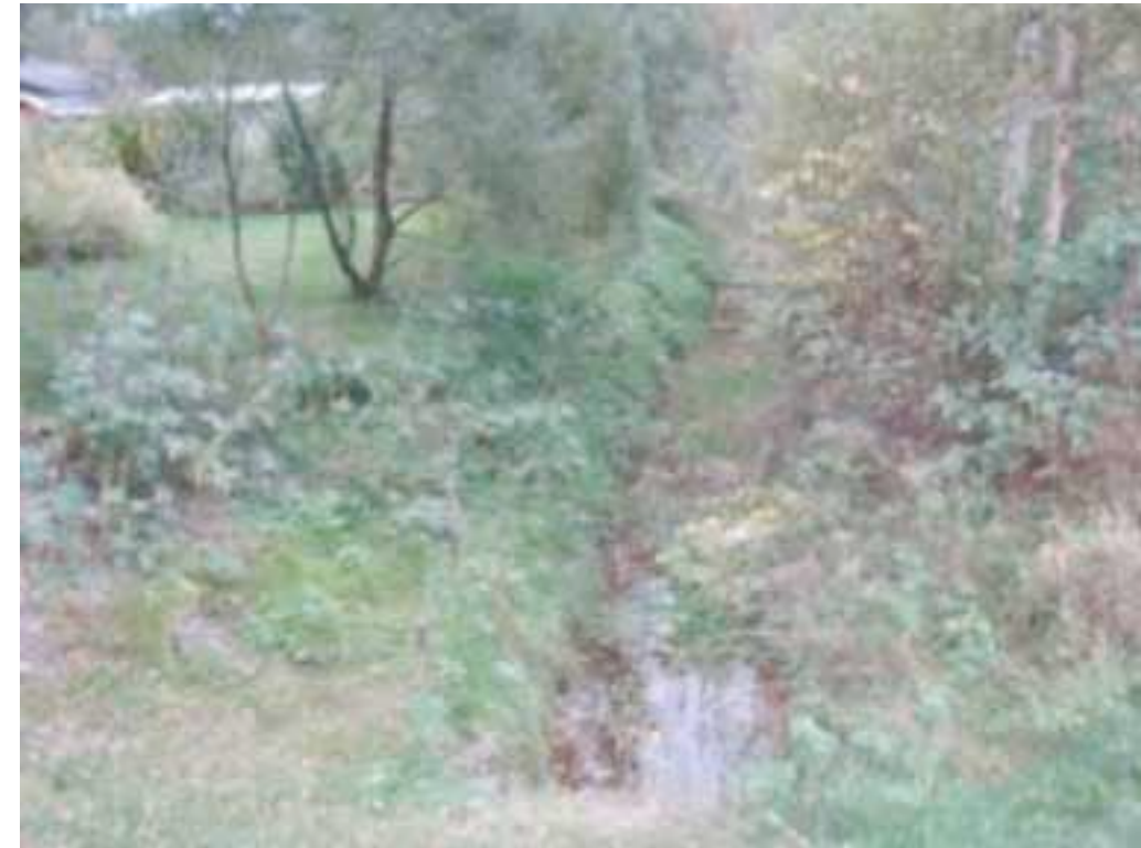
Kuva 17-14 Laiminlyöty ojan kunnossapito. (Kuva Johanna Mäkinen)
