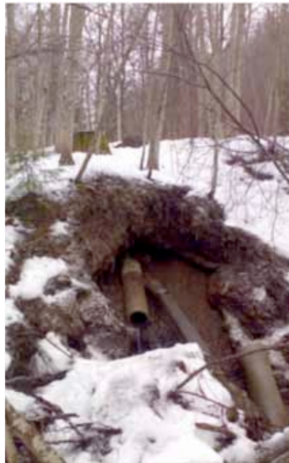
Kuva 17-35 Eroosion vaikutuksesta sortunut hulevesiviemärin purkupää.
