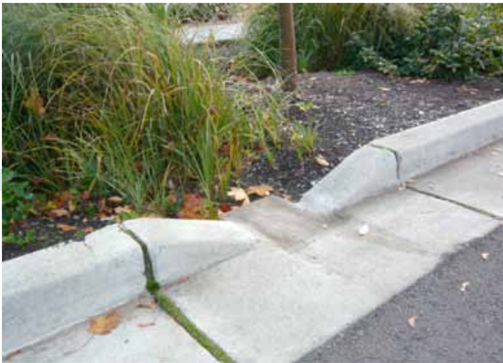
Kuva 14-24 Hulevedet voidaan johtaa painanteisiin esimerkiksi reunakiven aukosta, Seattle (FCG).
