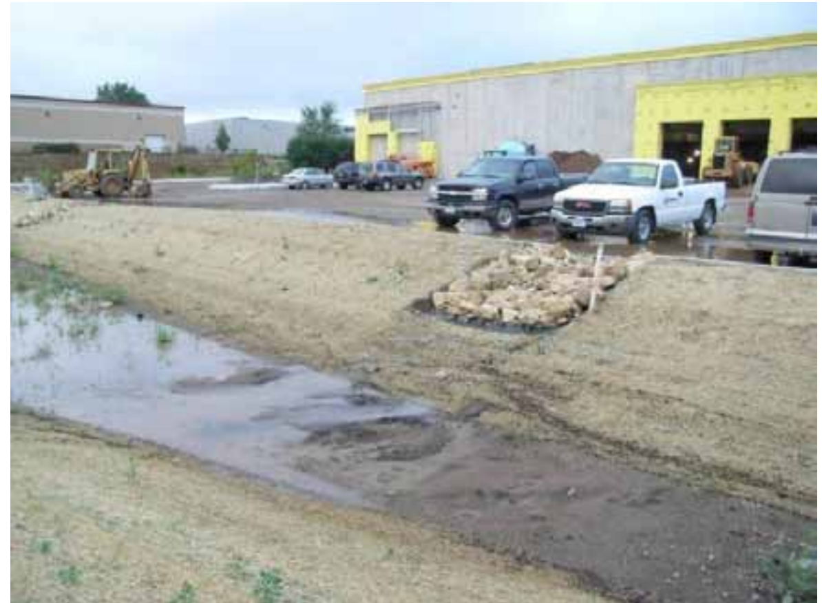
Kuva 19-15 Rakennustyömaan alkuvaiheessa tehty hulevesiallas, jonka laidat on suojattu eroosiolta olkimatolla ja tulovirtaaman kohta kivisuojuuksella, Minneapolis.
