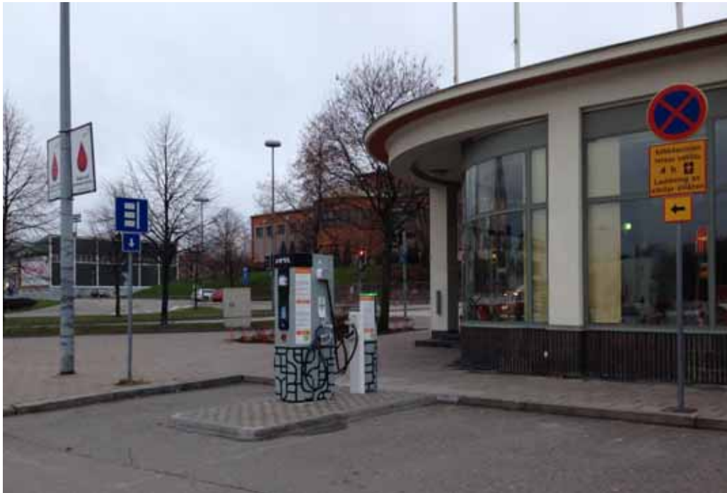
Kuva 20. Turun linja-autoaseman sähköauton latauspiste sijoitettuna korotetulle alueelle. Latauspisteessä on sekä perus- että pikalataus (Sito 2014)
