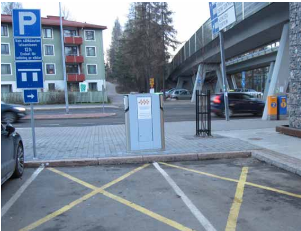
Kuva 19. Helsingin Siilitien metroaseman sähkökaappiin integroidut latauspisteet.
